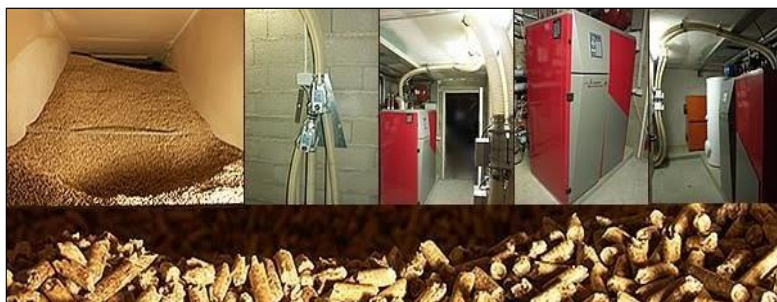
Figure 18 : Photos de silo et chaufferie
